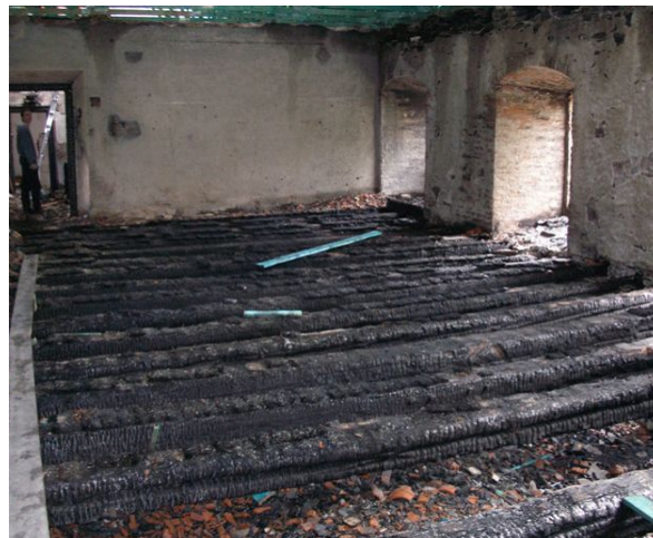
Obrázek 2 – nosné trámy po požáru.
